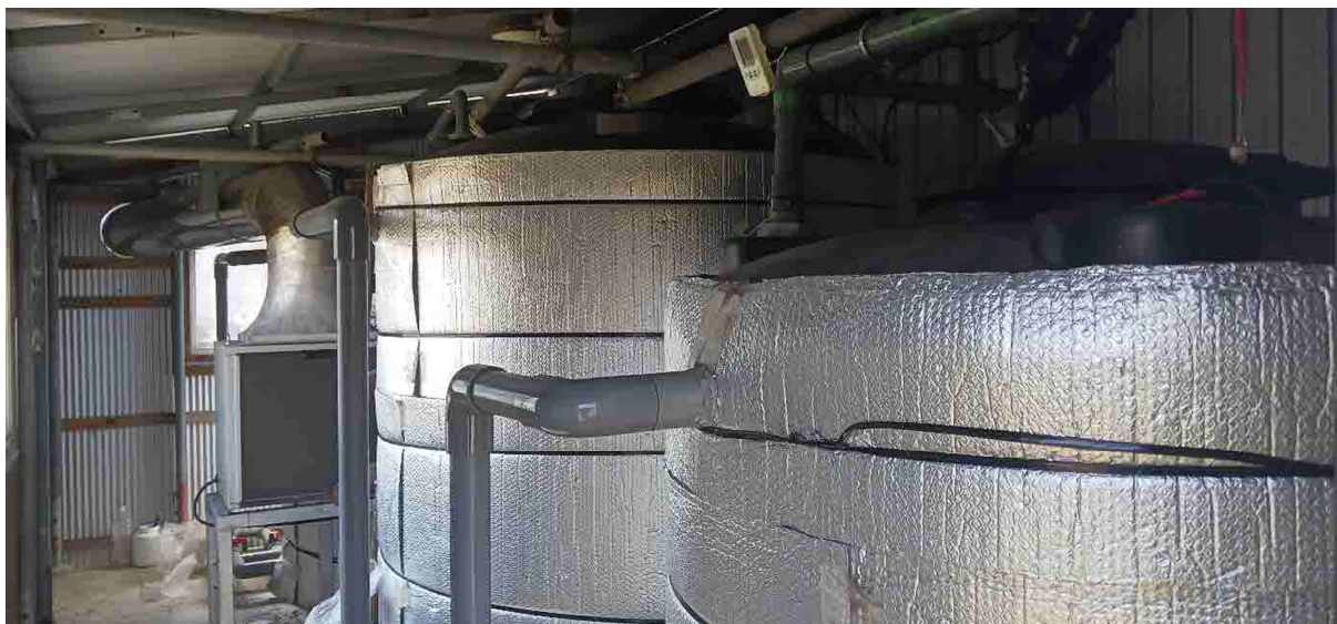
○灌漑水循環システム専用タンク
