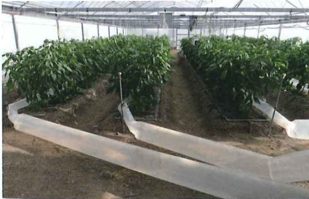
写真 ヒートポンプからピーマン株元へのダクト送風 (8月23日撮影)
