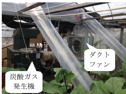
図2 ダクトの設置例（促成ナス）
