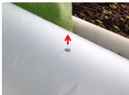
図3 植物体の株もとに配置したダクト（↑は吹き出し孔からのCO 2 の流れ）
